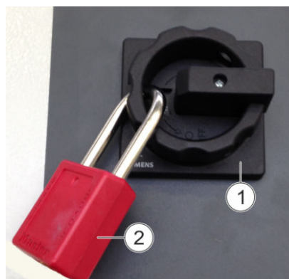
38. ábra: Hálózati leválasztó berendezés lakattal
